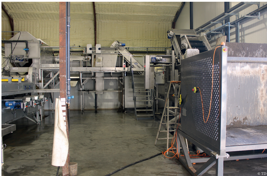
La nouvelle chaîne a été dimensionnée pour s'intégrer au bâtiment existant.
