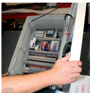
L'atelier électrique se situe également dans ce secteur de l'usine. Sur la photo, l'électricien finalise une armoire de station de lavage.
