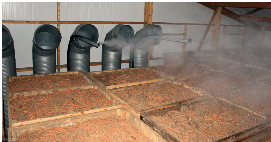
Sortie du groupe froid et buses de brumisation en haut du nouveau bâtiment de stockage carotte.
