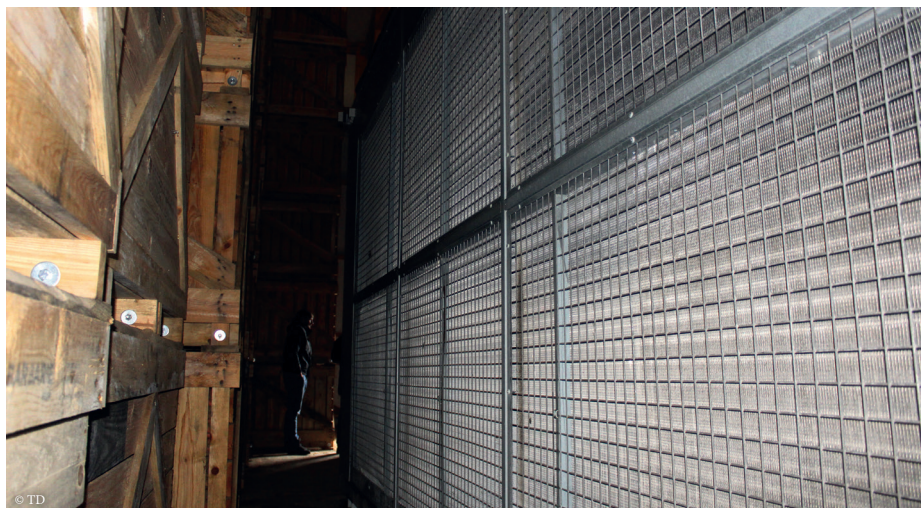
L'échangeur a une dimension de 7 mètres de longueur par 3,50 de hauteur.
